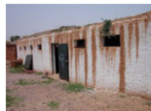
Figure 15 : Clapier moderne en pisé en service à l'ITA de Khénifra
